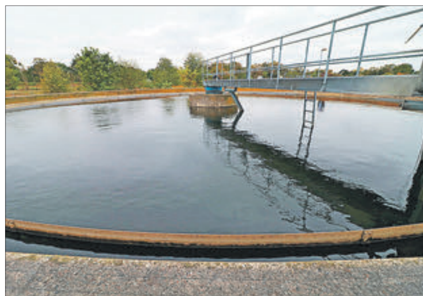
Die hier abgebildete Kläranlage in Wriezen sorgt neben der Anlage in Hohenwutzen für eine fachgerechte Säuberung des Schmutzwassers – bevor dieses wieder in die Natur zurückfließt.
