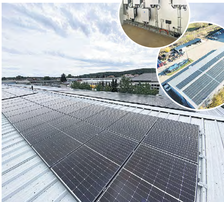
Dank der Installation der PV-Anlage können jährlich bis zu 52.000 Kilogramm CO 2 eingespart werden.
