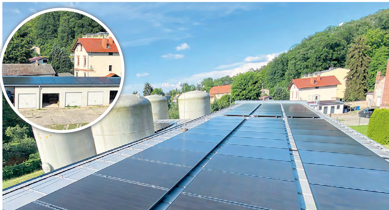
Mit der Installation von Photovoltaik-Anlagen spart der TAVOB jährlich große Mengen CO 2 ein.
